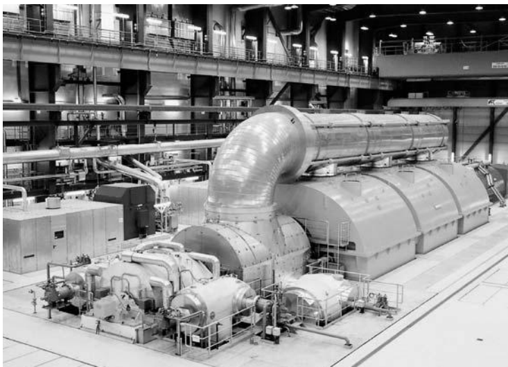
FIGUUR 1.12 Hal met turbogeneratoren
