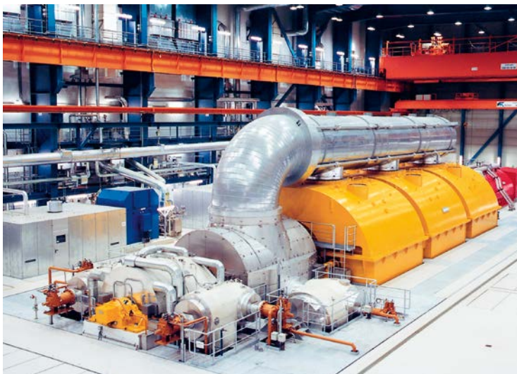
FIGUUR 1.13 Hal met turbogeneratoren
